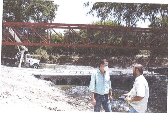
OBRA Y BENEFICIOS El alcalde Everardo Benavides verificó el avance de un puente peatonal de 35 metros, que incluye rampas lo que daría un total de 60 metros, cabe mencionar que se realizó un estudio para cimentación y la crecida del arroyo Las Sabinitas, beneficiando directamente a vecinos de tres colonias.
